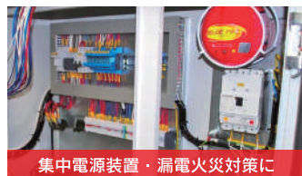
集中電源装置・漏電火災対策に
